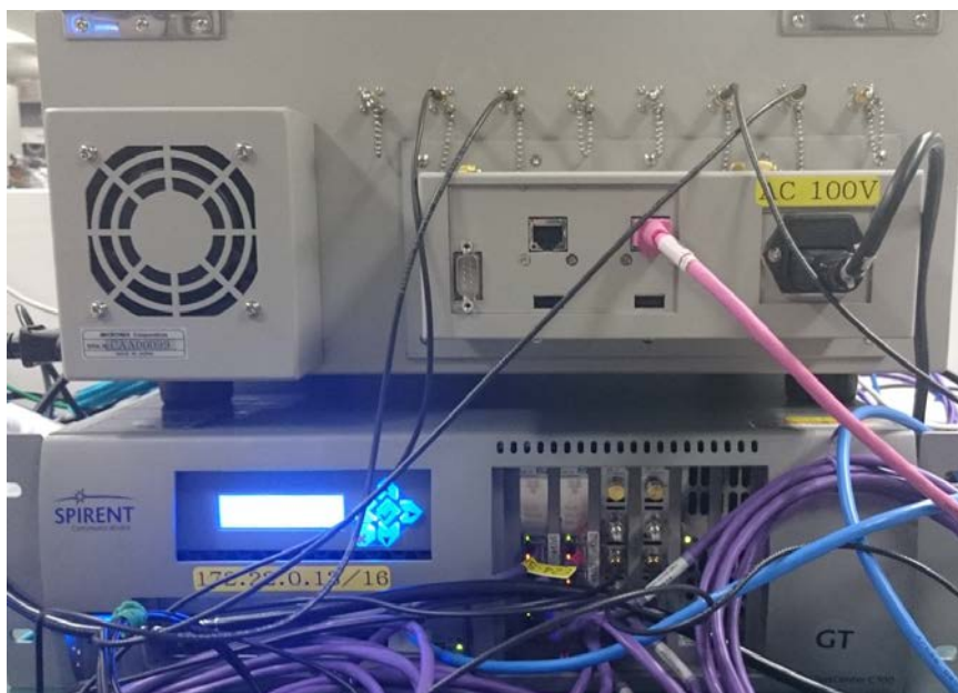
図 2 テスト用配線 (暗箱外側)
